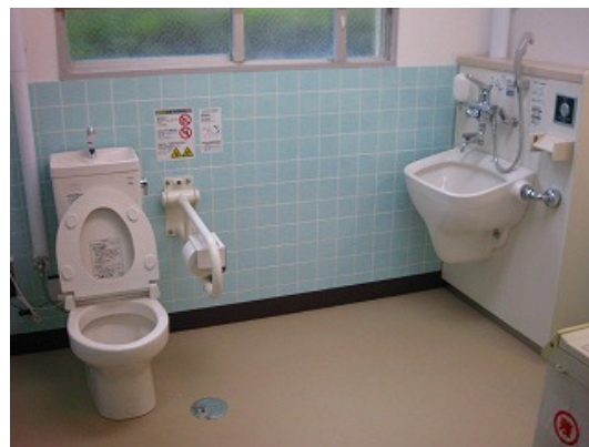
写真2 オストメイト用汚物流しを 設置した事例 （百草台コミュニティーセンター）
