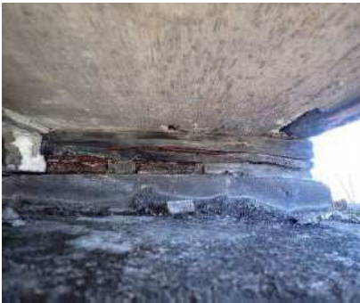
〔支承：変色・劣化〕 鋼板積層型ゴム支承で鋼板に腐食
