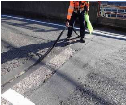
〔伸縮装置：変形・欠損〕
