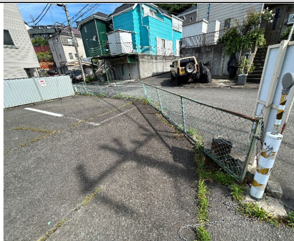
駐車場ネットフェンス 破損、傾き
