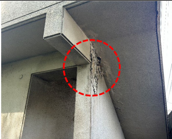
ホワイエ側屋外階段(上裏) 爆裂発生
