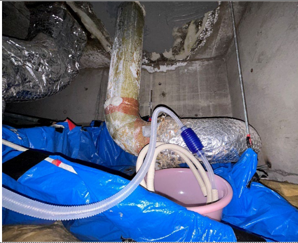
1階大ホール親子室 点検口内部に雨漏りあり
