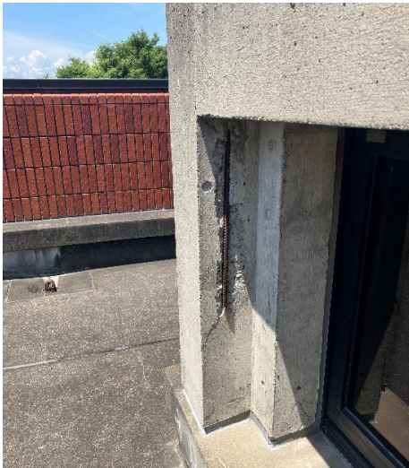
4階屋上外壁 爆裂発生
