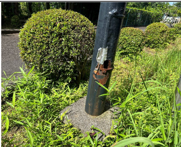
機械室裏手正面玄関側街路灯 支柱下部 発錆・劣化
