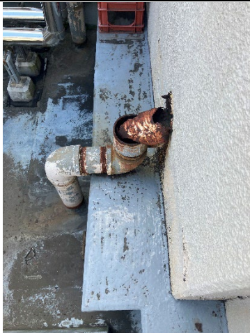
屋上排管 錆による腐食
