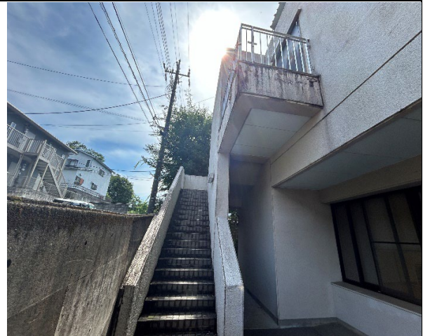
屋外階段(舞台側) 手摺無し(既存不適格)
