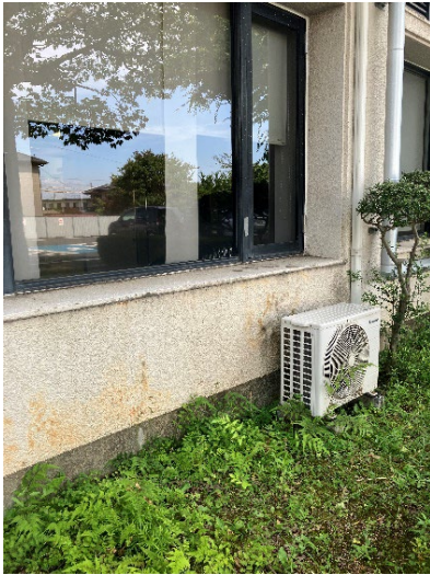
1階東側外壁 塗膜の浮きおよび錆汁の発生
