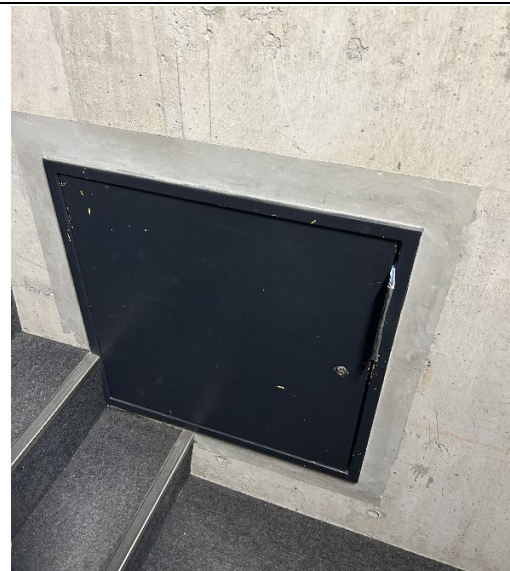
大ホール階段点検口 点検扉取付不良
