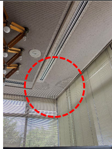
2階ホワイエ天井 漏水跡あり
