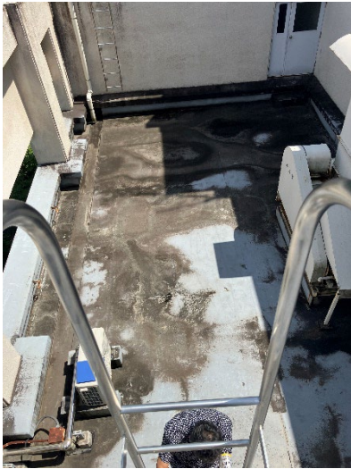
屋上防水 汚れあり
