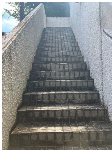
ホワイエ側屋外階段 汚れあり
