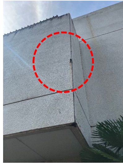
屋外階段横外壁 塗膜の剥がれ
