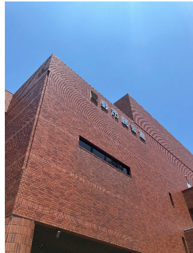
外壁文字盤 剥落
