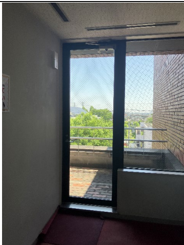
大ホール2階ホワイエ出入口(市役所側) ヒンジ調整による開閉不良
