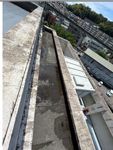
2 階屋上ルーフドレン 排水不良
