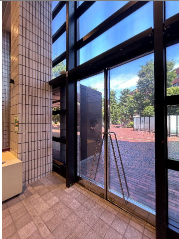
ピロティ出入口(庁舎側) 建具ゆがみあり
