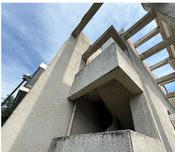
屋外階段(ホワイエ側) 汚れあり
